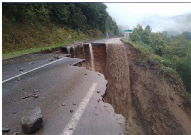
Figure 31: arrivée d'eau au niveau de la brèche
