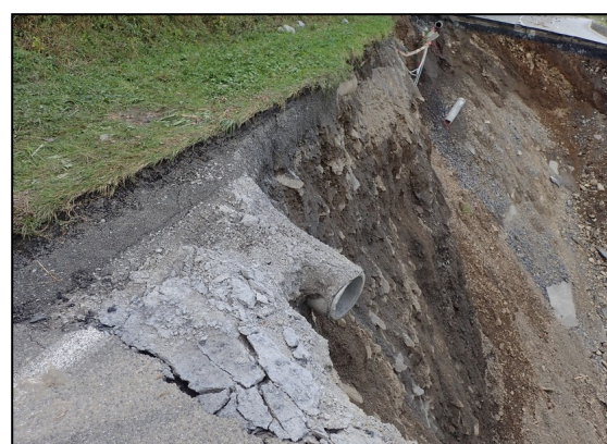
Figure 32: busage au niveau de la brèche
