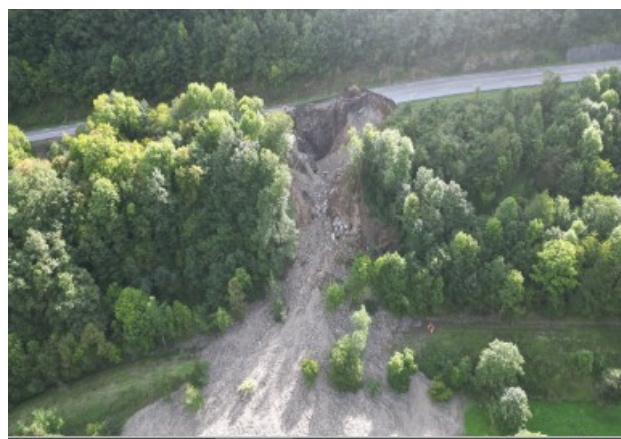
Figure 27: vue aérienne de la brèche
