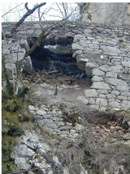
Figure 10: effondrement du mur aval
