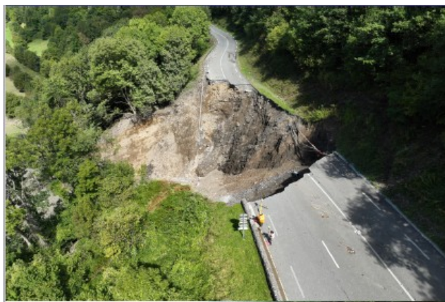
Figure 26: vue aérienne de la brèche
