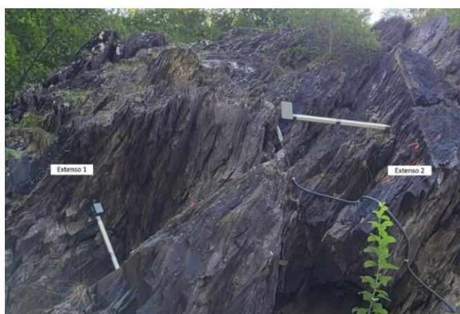
Figure 23: extensomètres sur blocs rocheux
