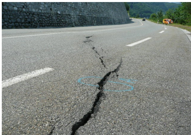
Figure 13: décrochement de la chaussée
