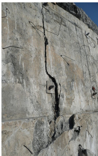
Figure 12: fracture sur paroi clouée amont
