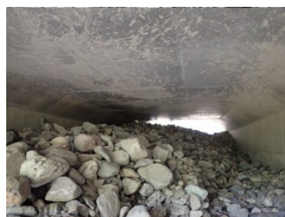
Figure 29: OH hydraulique comblé par les matériaux
